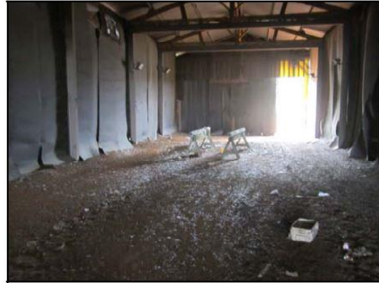
Figure 3 : Vue de l'atelier de décapage / sablage (13)
